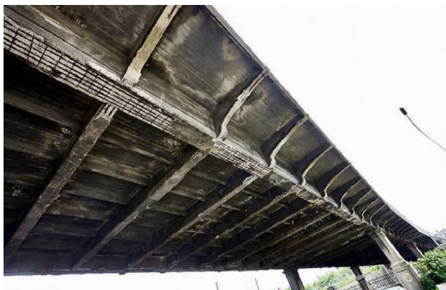
C'est souvent sous les ponts, au niveau du tablier, que l'entretien laisse à désirer, comme ici la rampe du Lion à Schaerbeek.
